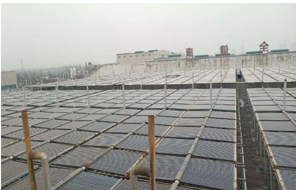
Solar Collectors 太陽能集熱設備
